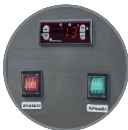
Controladores y termostato digital
